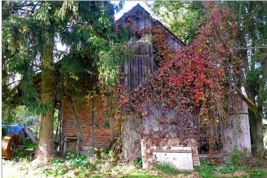
Abbildung 4: Der abzureißende Schuppen auf Flst. 57. Vorkommen von Fledermäusen am und im Gebäude sind nicht ausgeschlossen, ebensowenig gebäudebrütende Vogelarten (Schleiereule?); es sollte deshalb vor dem Abriss daraufhin untersucht werden.
