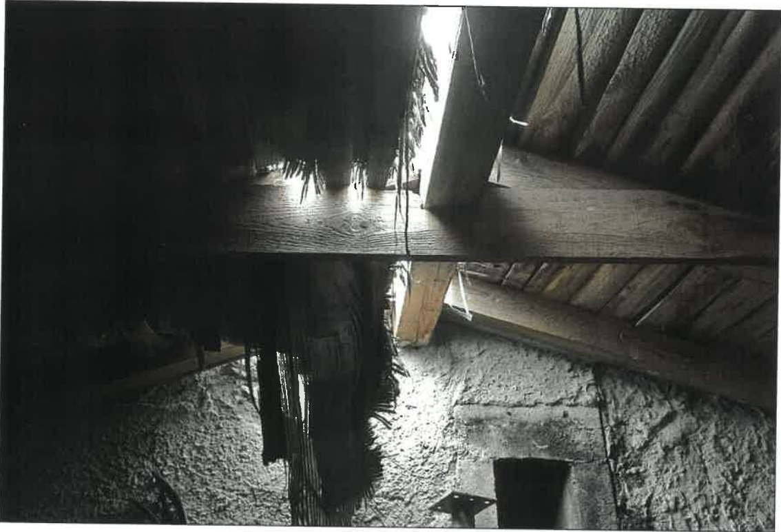
Abbildung 4: Das marode Dach von innen. 31.8.18.
